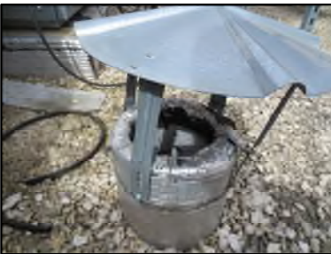
Photo N° 618 AMIANTE CIMENT - Toiture terrasse Planchers Ventilation haute (Fibres-ciment)
